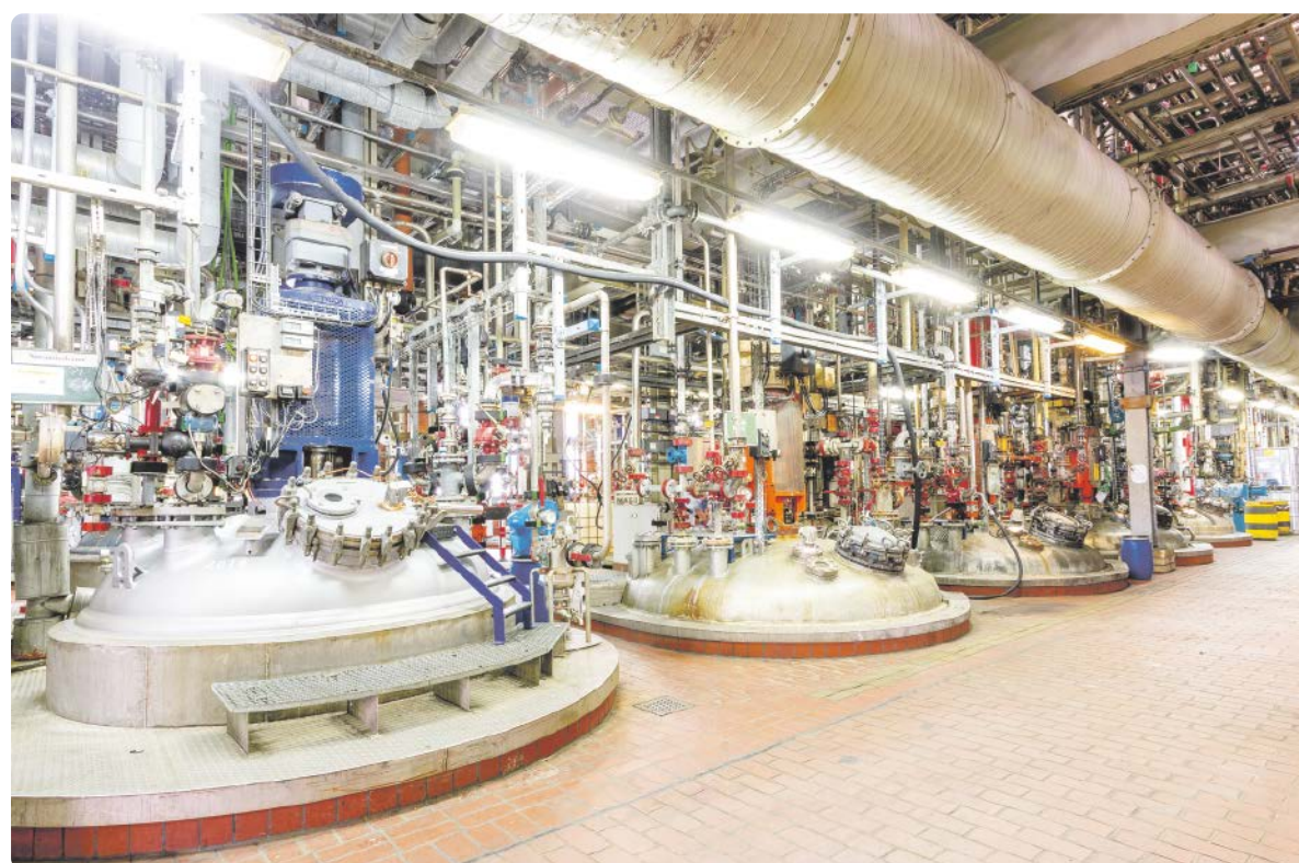
Pharma-Betrieb F34 der Allessa GmbH
