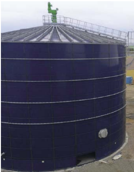
Abb. 1a: Typischer Biogasfermenter mit einem Zentralrührwerk.
