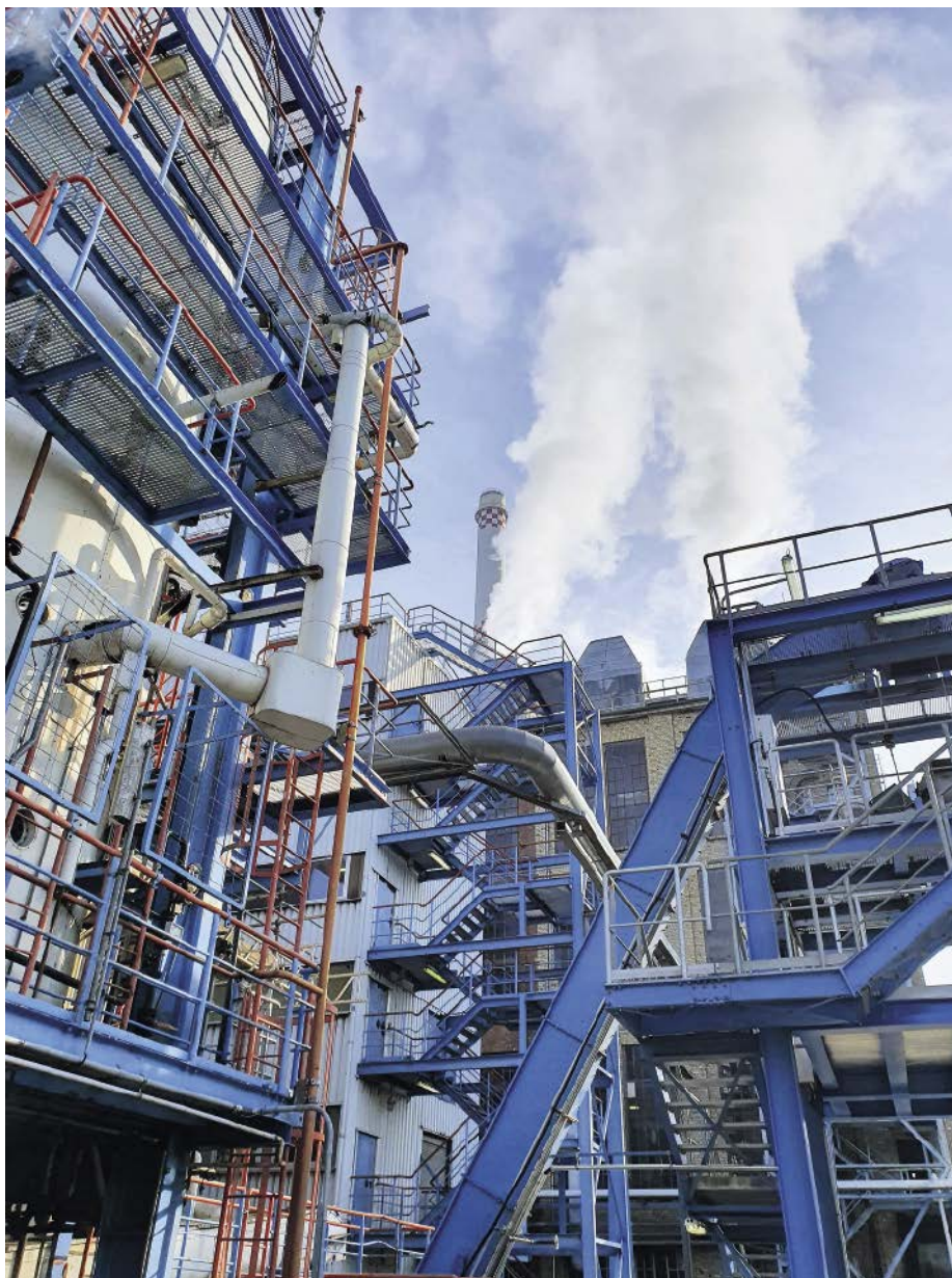
Abb. 1: Extraktionsanlage für die hohen Anforderungen des Produktionsprozesses.
