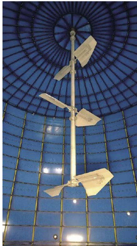
Abb. 1b: Biogasfermenter (hier innen emailliert) mit Außenansicht und Innenansicht mit Rührwerk.
