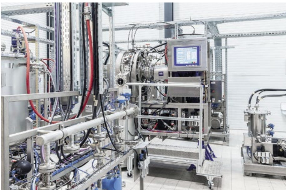
Abb. 3: Jede einzelne Station ist mit den erforderlichen Messgeräten und Regelarmaturen bestückt. Dazu zählen Durchflussmesser, Geräte zur Erfassung der Füllstände in den Behältern und Temperaturmessung.
