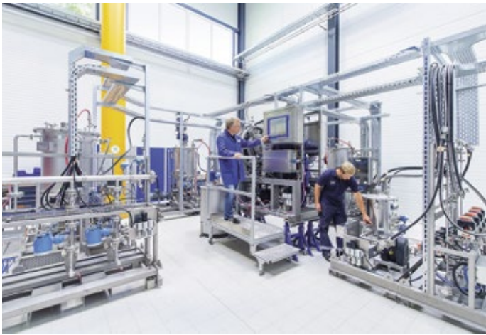
Abb. 1: Im hauseigenen Test Center hat BHS-Sonthofen eine modulare Versuchsanlage mit Pilot-Druckdrehfilter installiert.
