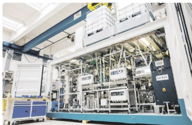
Wasserstofffreisetzungsanlage am Unternehmensstandort in Erlangen
