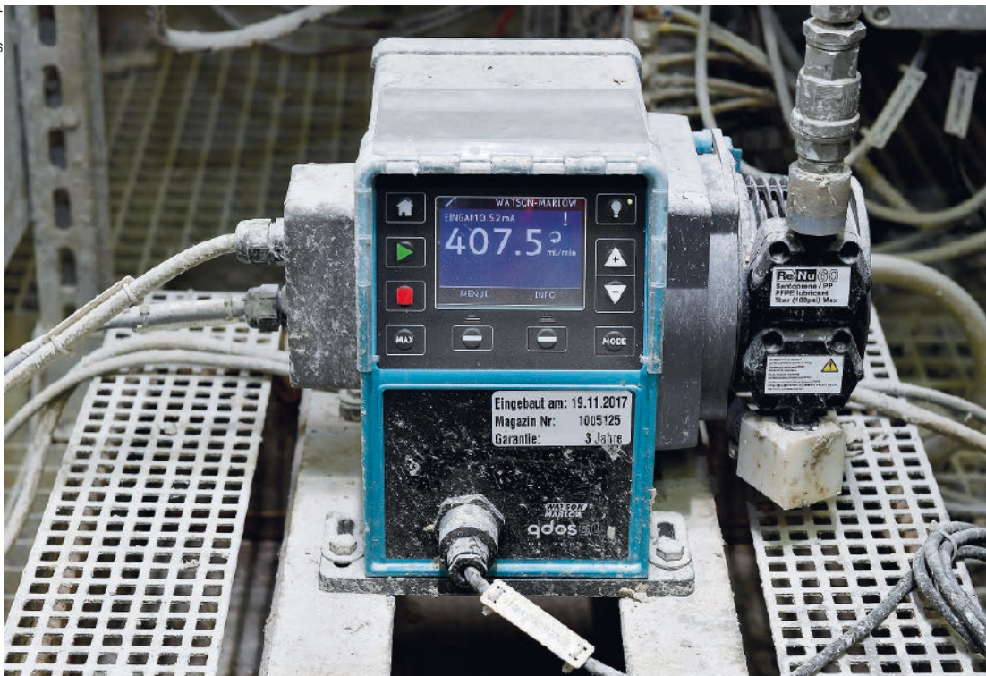
Abb. 2: An der Nasspartie der Kartonmaschine „KM3“, fördert die Qdos Dosierpumpe einen chemischen Entschäumer in das ablaufende Siebwasser. Hinsichtlich Dosiergenauigkeit und Wartung bietet die Schlauchpumpe eine erhebliche Verbesserung gegenüber der zuvor verwendeten Membranpumpen.
