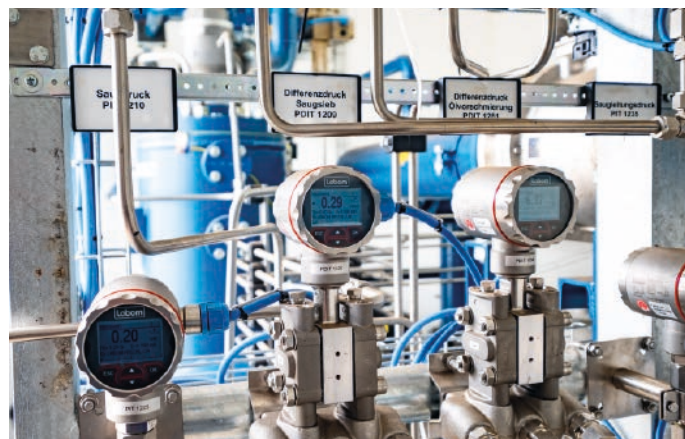
Abb. 3: Aerzen lieferte für EWE eine einbaufertige Komplettlösung inklusive Verrohrung und Anbindung an die Steuerungsebene.
