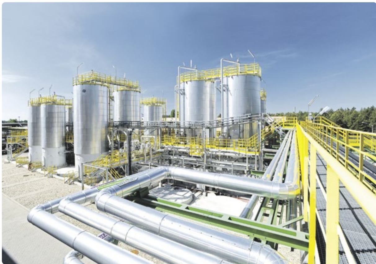
Tanklager der Sulphonierungsanlage 2 von PCC Exol in Brzeg Dolny (Polen).
