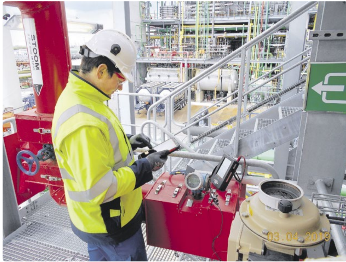
Loop Checks im Blick: Mit digitaler Anlagendokumentation hat der Projektleiter jederzeit den Überblick über den aktuellen Stand der Tests.
