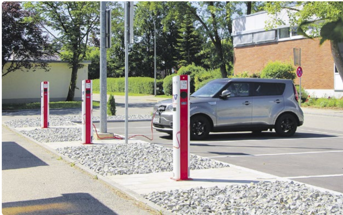
Im IP Gersthofen wurden als umweltfreundliche und energieeffiziente Alternative drei Strom-Ladesäulen mit sechs Ladeplätzen installiert.
