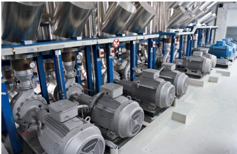
Abb. 2: Vor allem in Bestandsanlagen gibt es bei den installierten Pumpen noch viel Potenzial, um die Betriebskosten zu senken.
