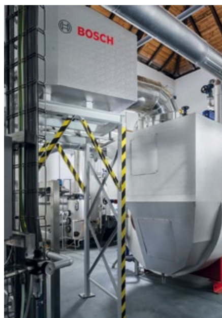
Abb. 2: Economiser und Brennwertwärmetauscher: Kosten sparen und Ressourcen schonen mit effektiver Abwärmenutzung.
