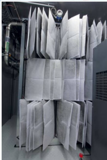
Abb. 4: Nahaufnahme der Kulissenschalldämpfer mit Pollenfilter.
