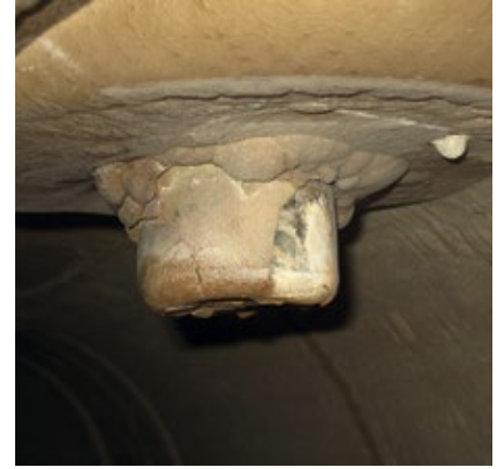
Abb. 3: Innenansicht eines Rohres mit Kalkablagerungen sowie der Ceramat WA 150 von unten
