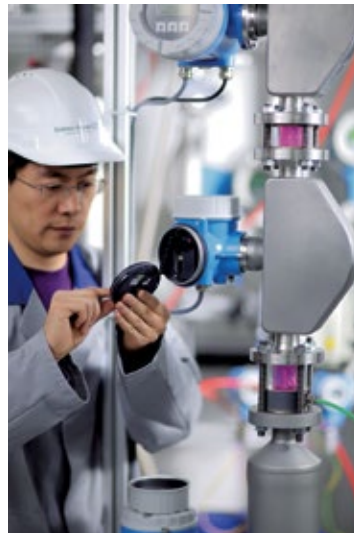
Abb. 3: Die Verifikation der Gerätefunktion bei der neuen Proline-Durchflussgeräteleinie mit Heartbeat-Technologie erfolgt vor Ort über das Geräte-Display.
