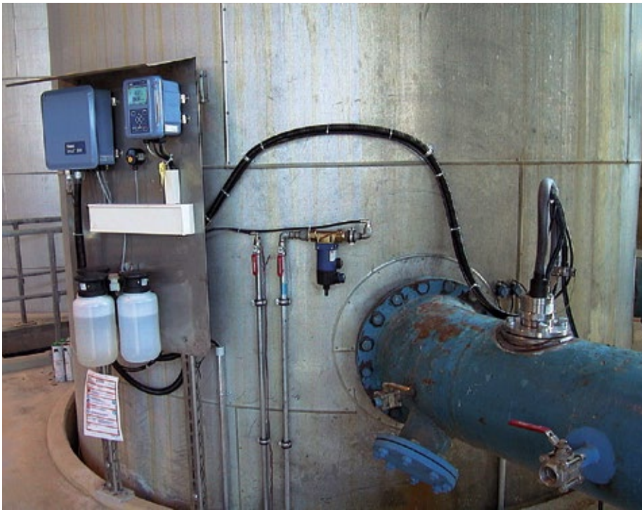
Abb. 2: Vollautomatische pH-Messstelle bestehend aus Ceramat WA 150, Unical 9000 C und Portos 3400 C
