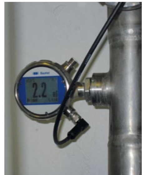
Abb. 2: Einsatz des CombiLyz in einer CIP-Anlage in der Lebensmittelindustrie.
