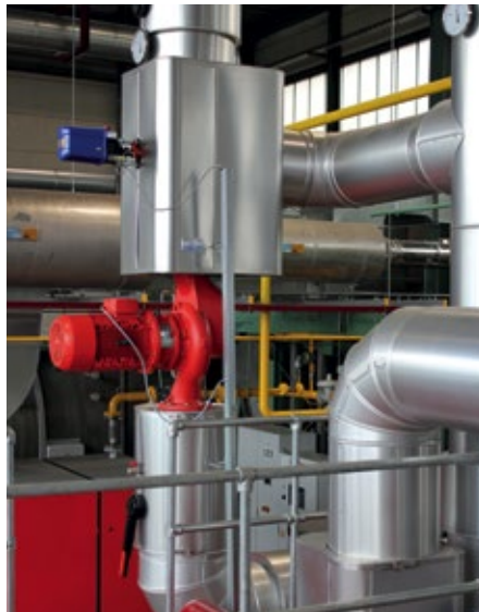
Abb. 6: An den Rückläufen zu den Gas-Großheizkesseln regulieren Mess- und Regelventile abhängig von der Soll-Temperaturdifferenz die Volumenströme. Als Kesselkreispumpen wurden Inlinepumpen der Baureihe Etaline eingesetzt.
