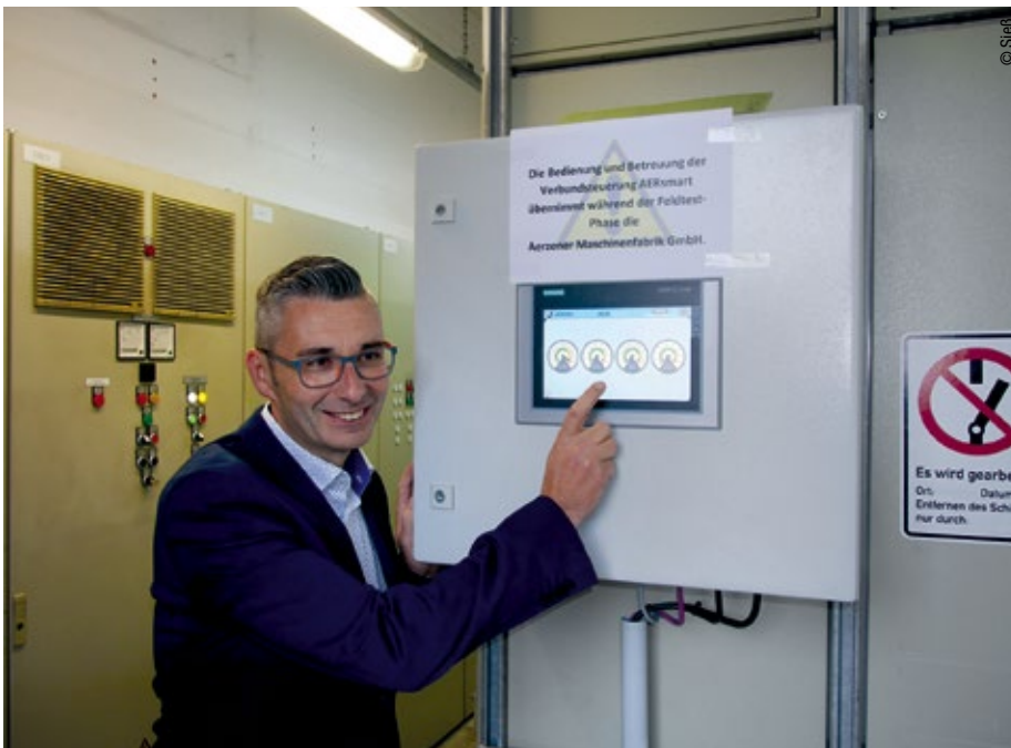
Abb. 4: Die Kläranlagen in Rheda-Wiedenbrück ist der erste Abwasserbetrieb in Deutschland, der die neue Aersmart Steuerung im Praxiseinsatz testet. Aerzens Abwasserspezialist Dipl.-Ing. Markus Leidinger, ist davon überzeugt, dass damit die Gebläse ganz nahe am Optimum fahren.
