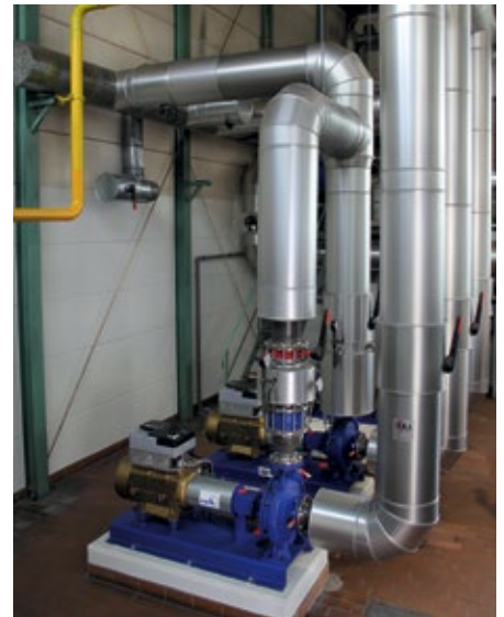
Abb. 7: Die „PumpDrive“ Pumpendrehzahlregelungen reagieren unmittelbar auf Änderungen des Wärmebedarfs.
