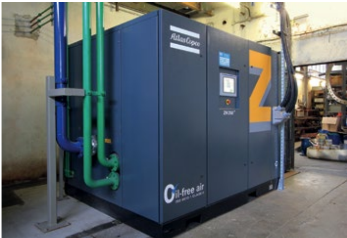
Abb. 1: Der Turbokompressor ZH 350+ erzeugt bis zu 3.800 m 3 Druckluft pro Stunde – und damit ausreichend für das ganze Werk.
