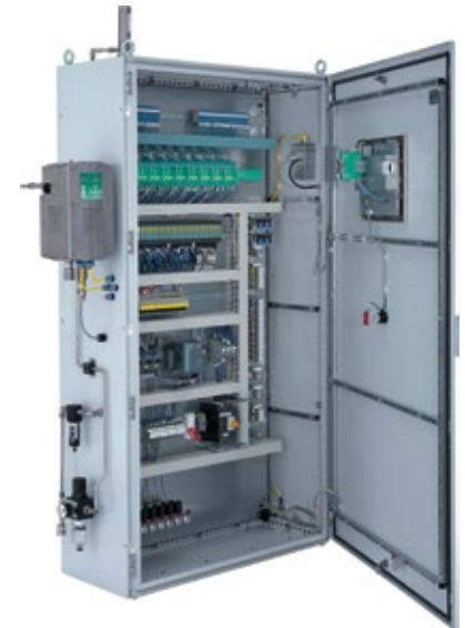
Abb. 3: Schaltschrank mit Überdruckkapselung, Eigensicherheits-Barrieren und Bedienmonitor im Inneren (MAC0003125)
