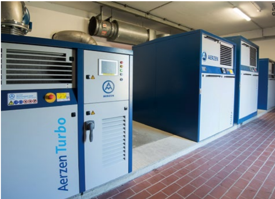
Abb. 3: Mit einer Kombination aus Turbogebläse, zwei Delta Hybrid und Delta Blower wird die Luft für die Belebungsbecken bedarfsgerecht und energieeffizient erzeugt.
