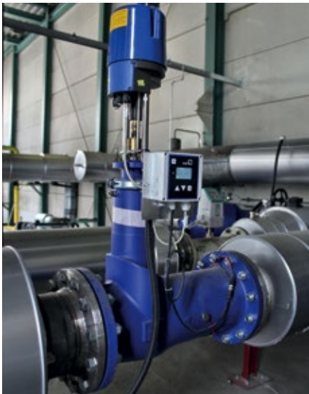
Abb. 5 Im Rücklauf des Heizungs-Hauptstrangs übernimmt das Mess- und Regelventil BOA-CVE Control IMS die Funktion zur Einhaltung der vorgegebenen Temperaturdifferenz, um die Rücklauftemperatur zum BHKW niedrig zu halten.
