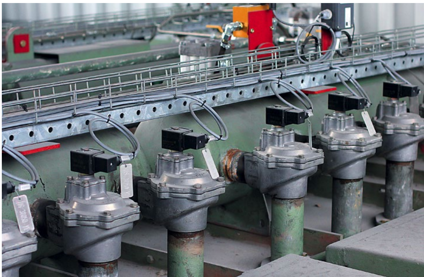
Abb. 2: Die Filteranlagen werden regelmäßig mit Druckluft-Impulsstößen gereinigt. Hierfür wird ein Großteil der in Hart erzeugten Druckluft aufgewendet.
