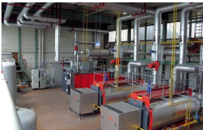
Abb. 1: Die Heizzentrale im KSB-Werk Pegnitz liefert nach der Modernisierung eine energieeffiziente Wärmeversorgung für die Produktionshallen und Bürogebäude.
