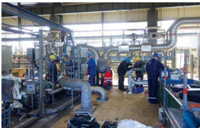
Abb. 2 Überall herrscht Hochbetrieb – wie hier im Maschinenhaus, wo Arbeiter den Läufer eines Kompressors überprüfen und justieren.
