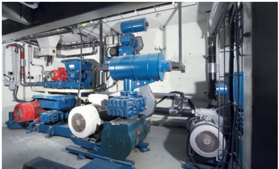
Abb. 2: Die Gebläse-Zentrale in Alsleben.
