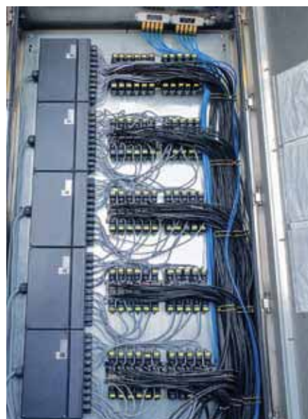
Abb. 2: Die bisherige, konventionell verdrahtete Lösung brauchte mehr Platz, ist nicht hot-swappfähig und ist aufwändiger verdrahtet.
