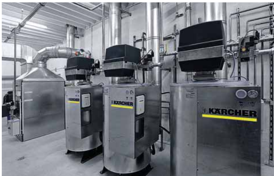
Abb. 2: Moderne Heißwasseranlagen sollten über einen Energiesparmodus verfügen, der eine Auskühlung des Brenners zwischen Heiß- und Kaltwassernutzungsphasen verhindert.
