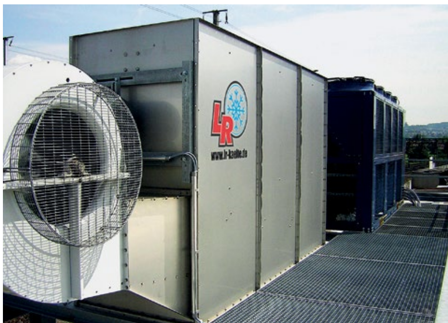
Abb. 1: Das MHP-System hält das Kreislaufwasser in Kühltürmen hygienisch stabil.
