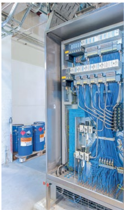
Abb 5: Während Schaltschränke für nicht Ex-Bereiche meist klassische Configure-to-Order-Bestellungen (CTO) sind, gibt es für Ex-Bereiche oft noch zusätzliche Anforderungen, z.B. Erwärmungsmessung, E-Plan-Makros oder spezielle Parametrierung.
