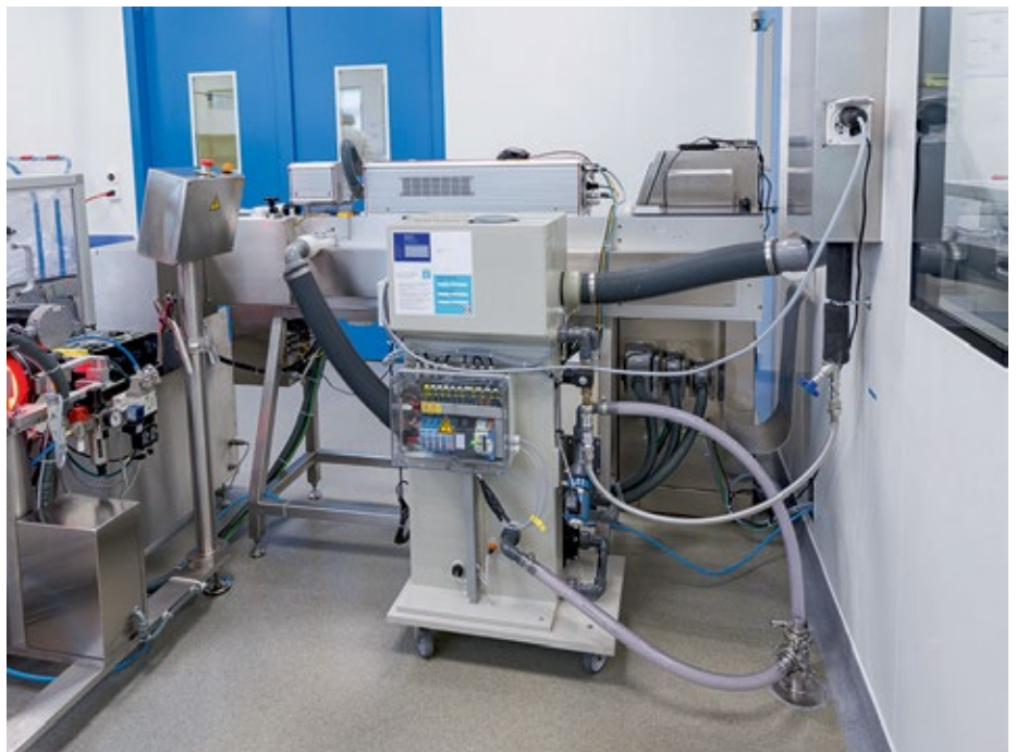
Abb. 1: Der Reinigungskreislauf des Abluftwäschers besteht aus integrierter Pumpe, Polypropylen-Füllkörperschicht, Waschflüssigkeit und Ventilator und bewirkt eine intensive Auswaschung der Salzsäure direkt am Entstehungsort.
