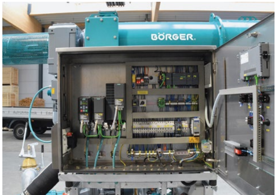
Abb. 4: Im Schaltschrank dieses Bioselect befindet sich der Fernwartungsrouter eWON Cosy 131 von Wachendorff neben einer Siemens-SPS. Der Fernzugriff erfolgt nicht direkt, sondern über einen geschützten VPN-Tunnel, der durch das kostenlose Portal Talk2M sicher gestellt wird.
