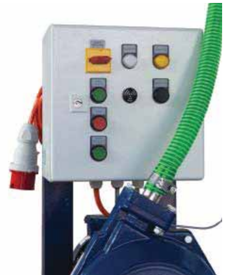
Abb. 3: Die Pumpensteuerung, Start-, Stop- und Not-Halt-Taster, sowie Leucht- und Akustikmelder sind in einem IP66-Schaltschrank untergebracht.
