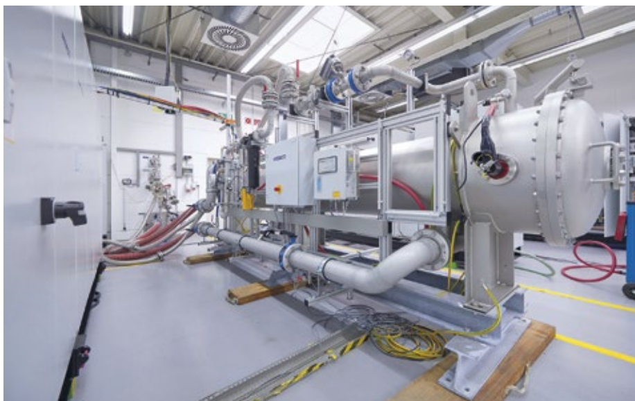
Abb. 1: Die Firma Xylem entwickelt und produziert am Standort Herford Ozon-Anlagen u.a. für die Desinfektion von Wasser.
