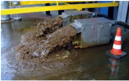
Abb. 4: Austrag von Verunreinigungen aus einem industriellen Kühlsystem.
