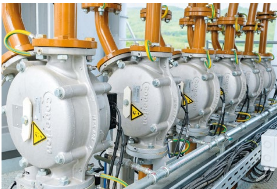
Abb. 3: Der Braunkohlestaub wird von Delta Blowern von Aerzen durch Brennerlanzen hindurch in den Brennofen geblasen.
