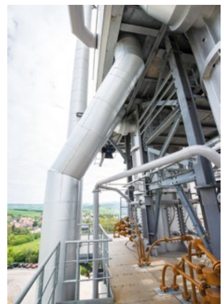
Abb. 4: Die Dimension der Rohrleitungen lässt erahnen, wie hoch der Bedarf an Prozessluft in GGR-Öfen ist.
