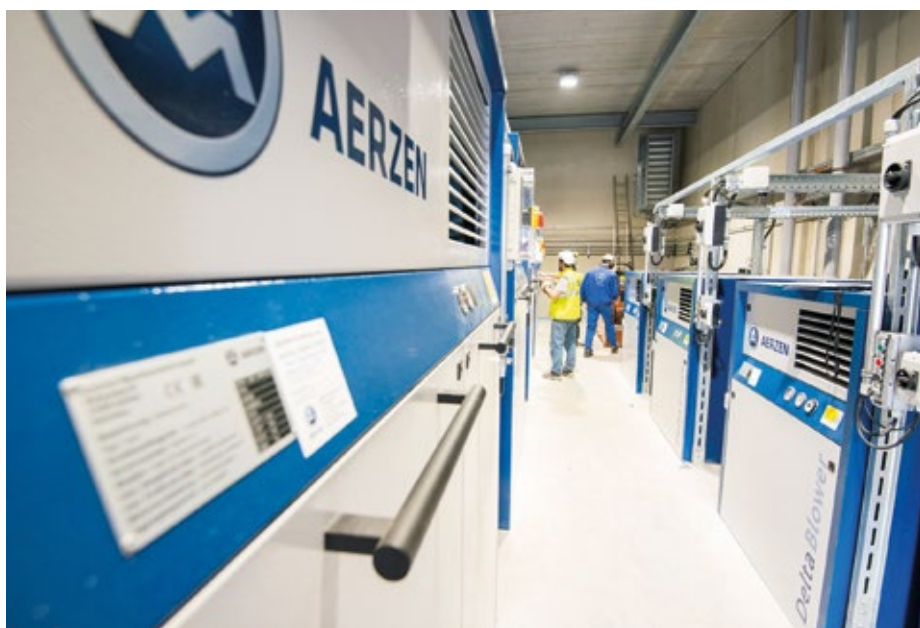
Abb. 1: Bei Köhler Kalk in Hessen sorgt ein Maschinenpark aus Delta Hybrid und Delta Blower für die Prozessluft.
