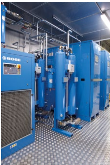
Abb. 2: Für den Betreiber einer Erdgasverdichterstation hat Boge zwei Schraubenkompressoren, je zwei Kälte- und Adsorptionstrockner und zwei Stickstoffmembrangeneratoren in einem 40-Fuß-Sondercontainer kombiniert.
