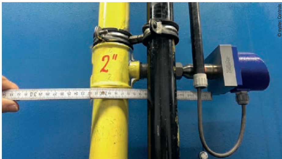
Abb. 1: Der Differenzdruck Massenstrom-Durchflussmesser deltaflowC, installiert an einer Brenner-Gasleitung
