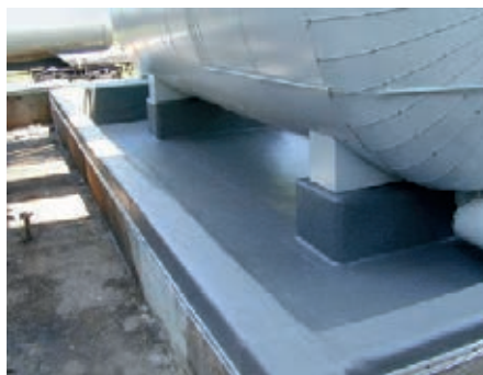
Abb. 1: Auffangräume unterliegen besonders im Raffineriebetrieb einem Kontaminationsrisiko. Daher muss stets auf eine zuverlässige Abdichtung geachtet werden.
