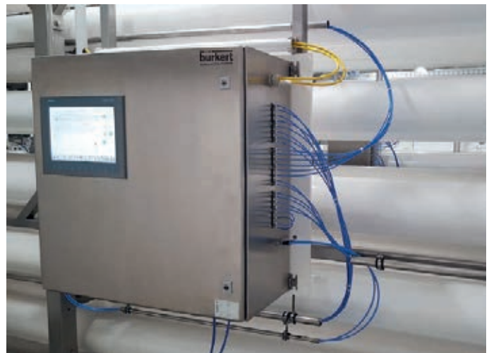
Abb. 2: Das Permeat-Monitoring-System kommuniziert mit der übergeordneten Steuerung der Trinkwasseraufbereitungsanlage und mit dem Leitsystem des Wasserwerks. Dadurch haben die verantwortlichen Mitarbeiter den Zustand der Filtermodule immer im Blick.
