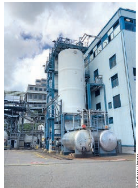
Abb. 2: Behälter der Abwasservorbereitung.
