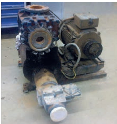
Abb. 3: Ausgebrannte Komponenten nach Funkenerzeugung in der Gebläsestufe.
