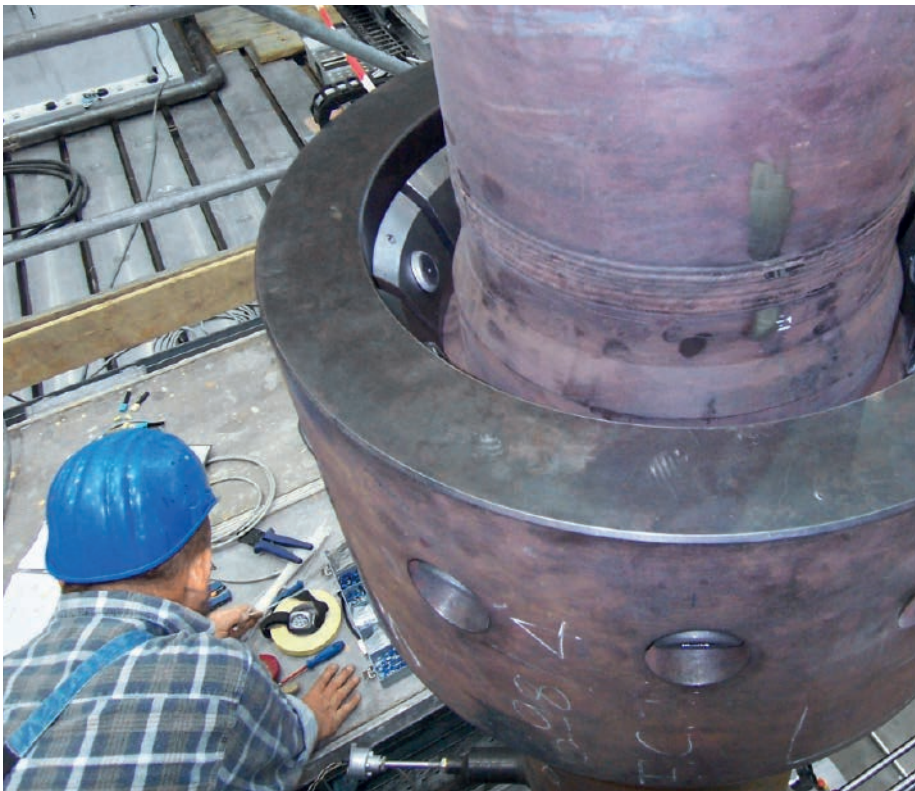
Abb. 1: Beispiel Rohrleitungsverbindung, Probedruck 741 bar – extrem belastete Verbindung an einem Pumpenprüfstand der KSB.
