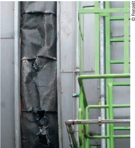
Abb. 1: OEM-Ausrüstung: Das Faltenbalg-Gewebe des Standardformkompensators hält unvorhersehbaren Pulsationen in Entstaubungsanlagen nicht stand, wird porös und muss ausgetauscht werden.
