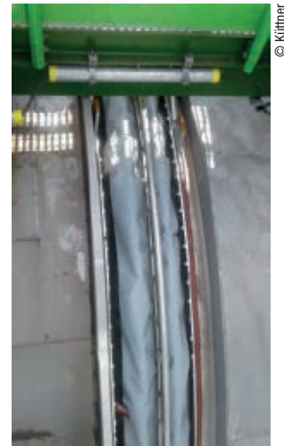
Abb. 3: Der installierte Frenzelit-PTFE-Verbundkompensator, ausgelegt für auftretende Druckwechselbelastungen und Pulsationen.
