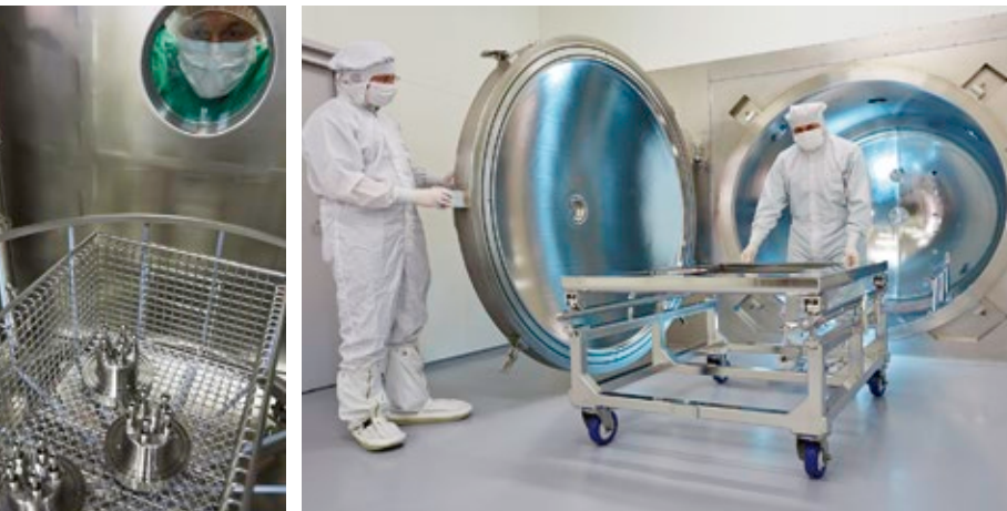
Waschanlage mit Vakuumtrocknung (links) und UHV-Restgasanalyse-Kammer (rechts) – beide in Schleusenbauweise zum ISO-6-Reinraum
