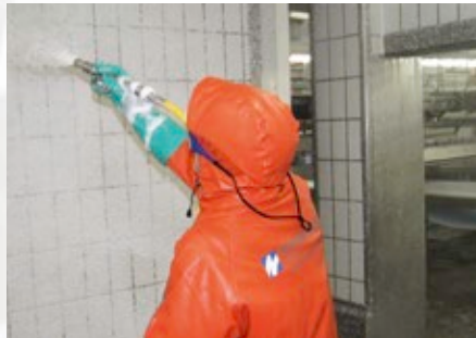
Abb. 1: Mit Wasser bei einem Druck von 20 bis 25 bar werden zunächst grobe Rückstände von Anlagen, Wänden und Böden entfernt.
