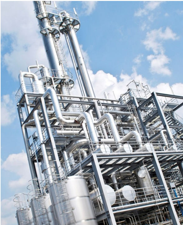
Trinkalkoholanlage – geplant und realisiert durch Vogelbusch
