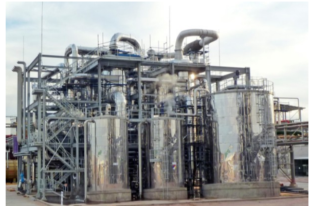
Eindampfanlage – geplant und realisiert durch Vogelbusch
