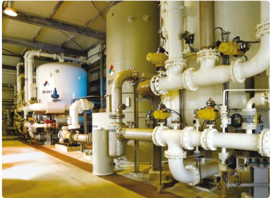
VE-Wasseraufbereitung bei Dow Chemical in Stade
