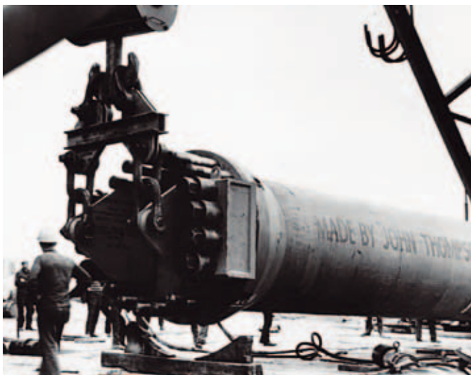
... der aus England für die Ammoniakanlage geliefert wurde
