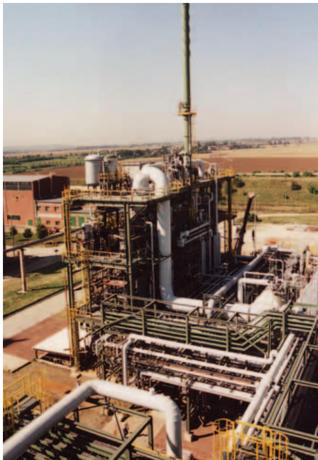
Die Oxichlorierungsanlage in Buna (Teilsicht)
