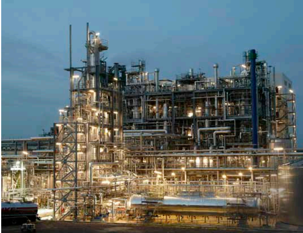
Gesamtansicht der Melaminanlage in Piesteritz
