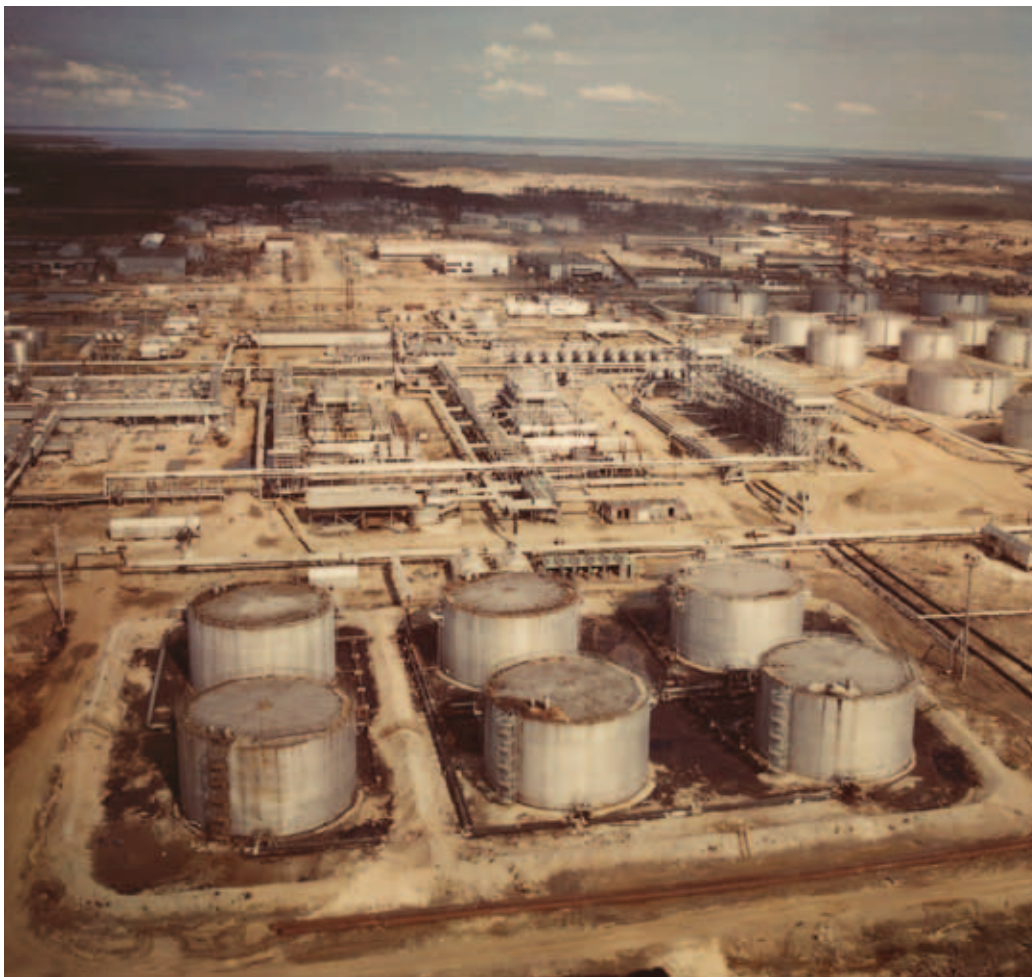
Gesamtansicht einer Erdölaufbereitungsanlage in Sibirien
