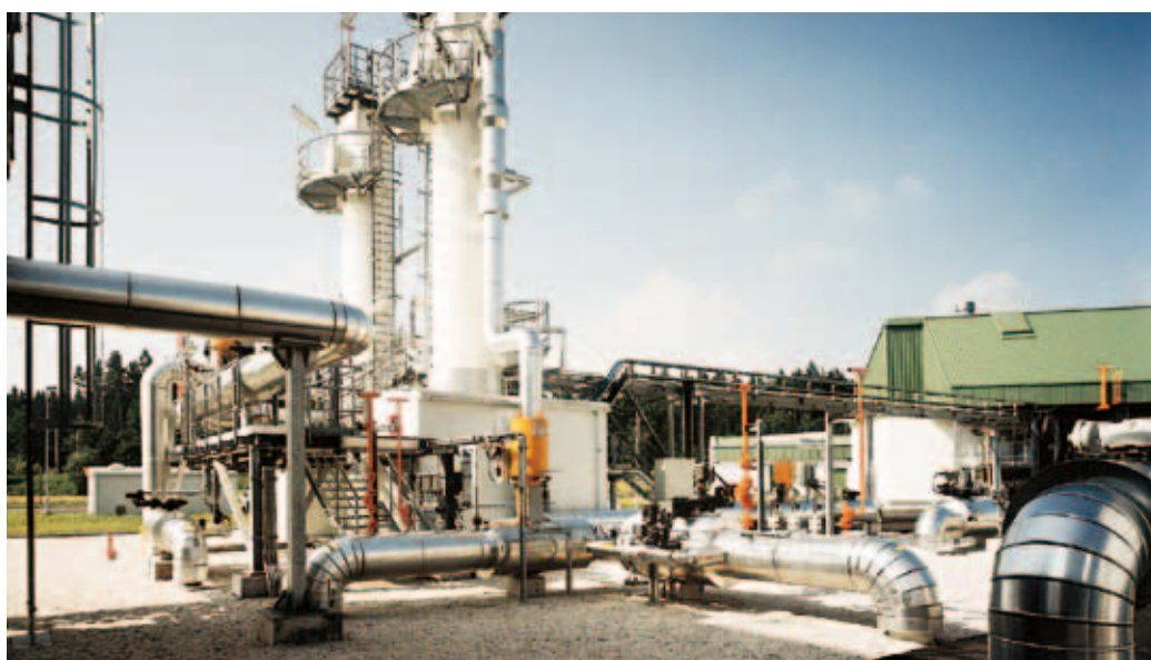
Erdgasuntergrundspeicher in Puchkirchen/Österreich
