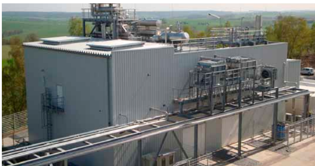
Benzinanlage in Freiberg
