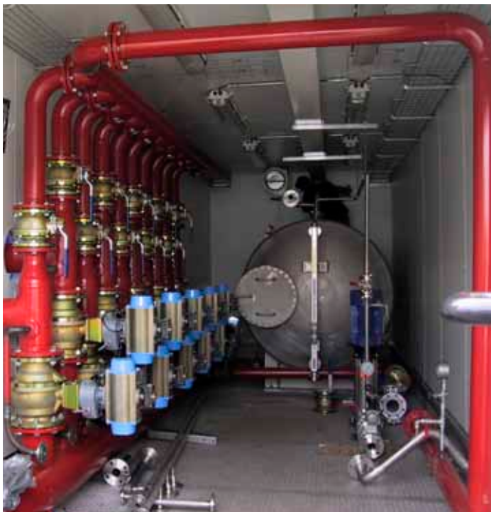
Teilansichten der Verladeanlage und des Tanklagers...
