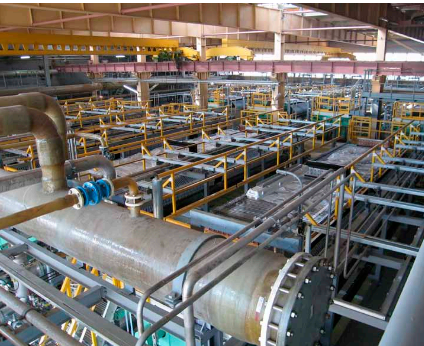
Zellensaal der Chlorelektrolyseanlage in Sajansk
