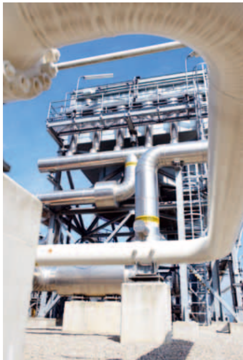
Erdgasuntergrundspeicher Haidach II
