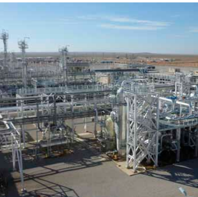
Teilansicht der Gasaufbereitungsanlage Syrien
