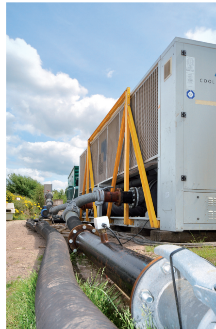
Abb. 3: Massive 6-Zoll-Schlauchleitungen verbinden den Kaltwassersatz mit dem vorhandenen System.
