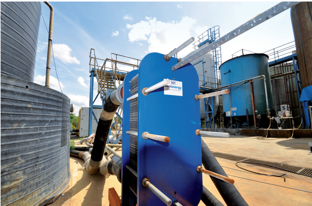
Abb. 2: Ein Baustein der Anlage ist dieser leistungsstarke Plattenwärmetauscher.
