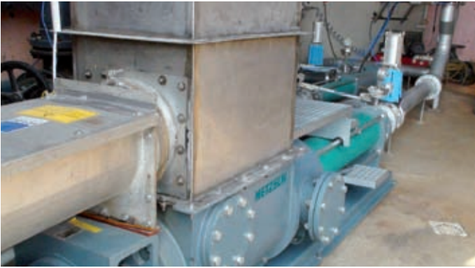
Abb. 1: Herzstück der Flüssigfütterung sind die Nemo B.Max Mischpumpe (Vordergrund) sowie die Nemo BY Substratpumpe (Hintergrund).
