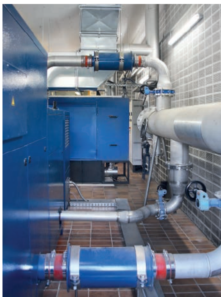
Abb. 2: Alle drei Aggregate – Delta Blower, Hybrid und Turbo – sind an eine gemeinsame Rohrleitung angeschlossen.
