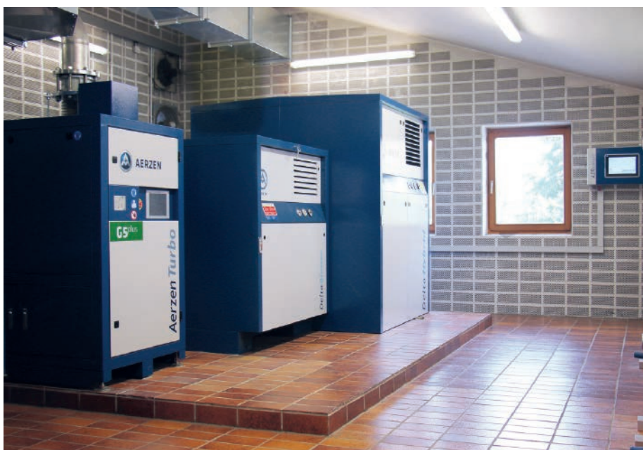
Abb. 1: In der Kläranlage Oberschleißheim sorgt ein Aerzen Performance 3 -Technologiemix bestehend aus einem Turbo, einem Delta Blower und einem Hybrid für die effiziente Druckluftversorgung in den Belebungsbecken. Rechts im Bild: die Verbundsteuerung AERsmart
