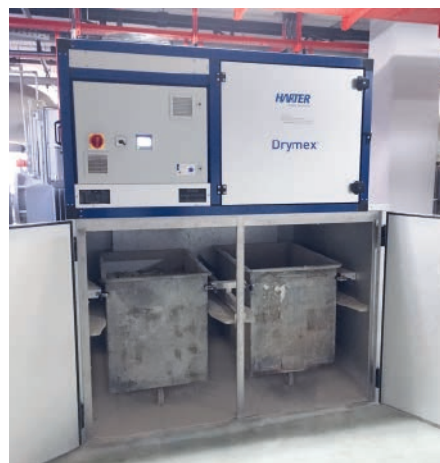
Abb. 1: In 2 Containern werden jeweils 1,5 t filtergepresster Schlamm bei 50 °C bis zu einem Trockenstoffgehalt von 85 % getrocknet
