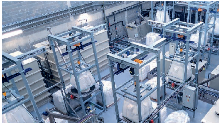
Abb. 2: Sera PolyLines in der Kläranlage Prag
