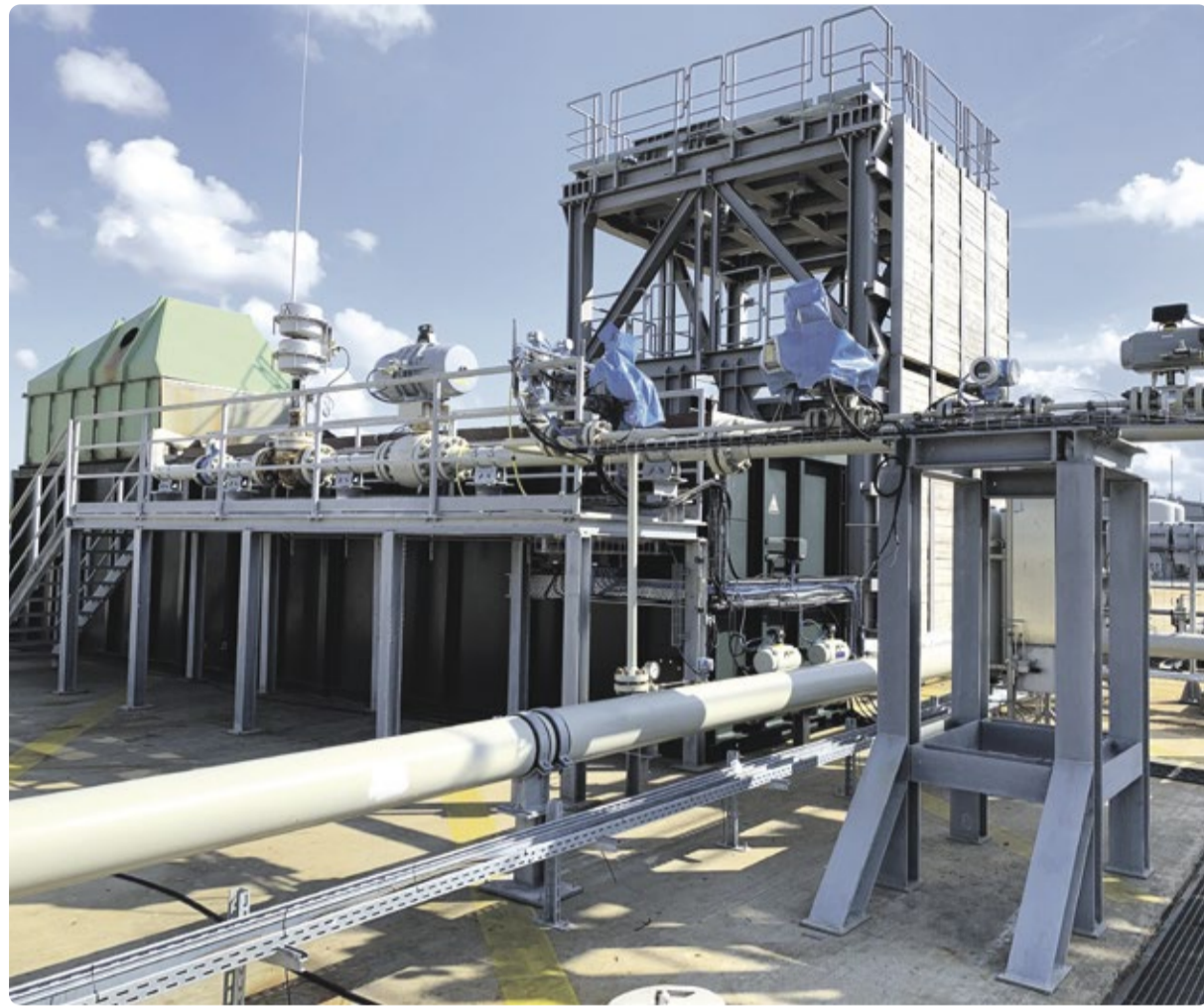
Anlage zur Gaserstbefüllung der Erdgaskavernen in Jemgum. Im sicherheitskritischen Umfeld galt es, die einschlägigen Vorgaben für den Ex-Schutz und die funktionale Sicherheit zu beachten. Nach der Kaltinbetriebnahme musste die Sicherheitstechnik durch Sachverständige freigegeben werden
