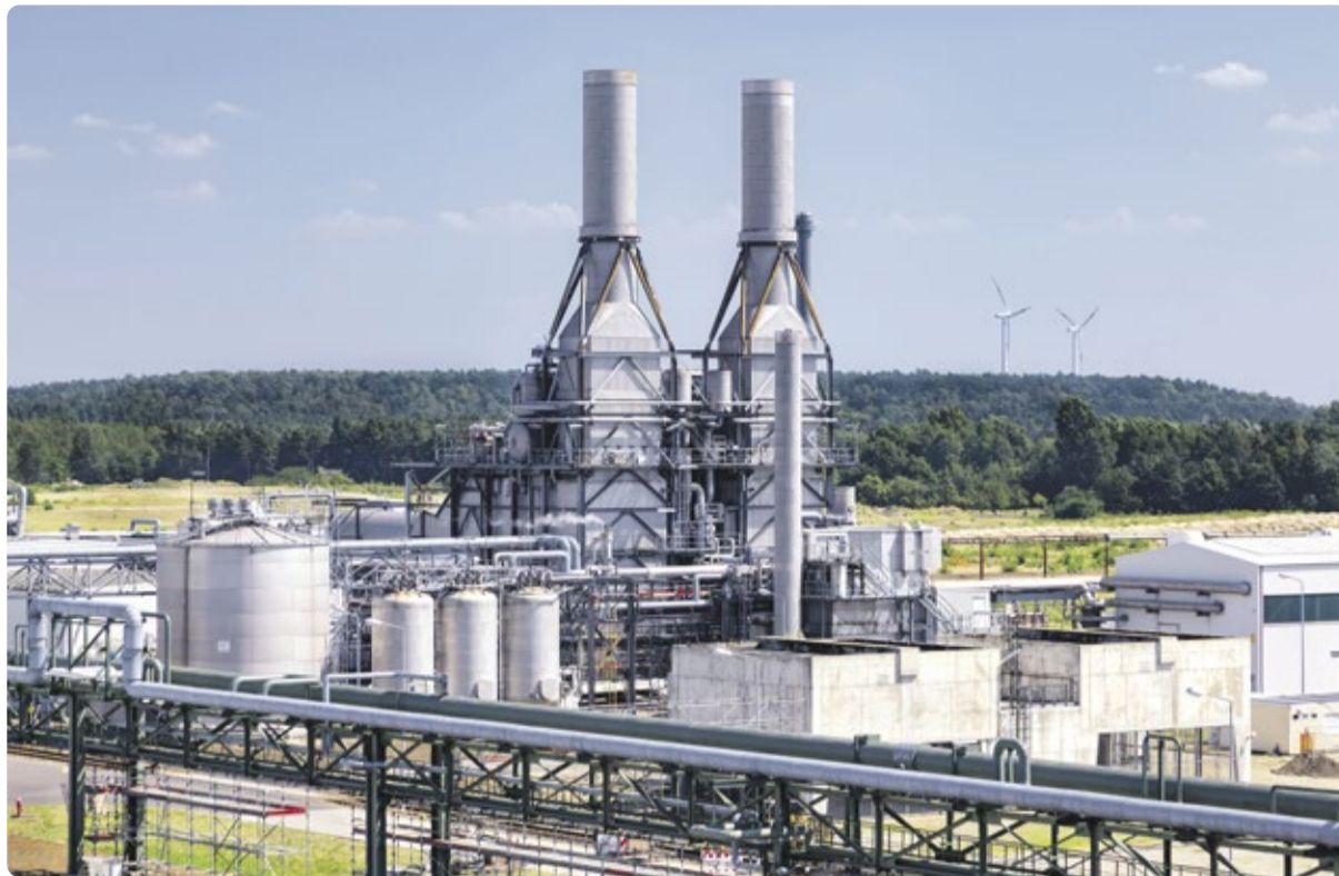
Das modernisierte GuD-Kraftwerk ist für das Chemieunternehmen der Schlüssel für eine Vision.
