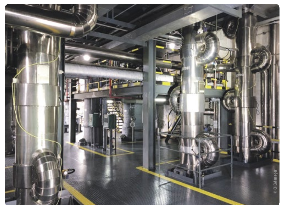
Integration der kontinuierlich laufenden Miprowa Flow-Reaktoren in die bestehende Gebäudeinfrastruktur bei Shaoying Eastlake in China nahe Shanghai.
