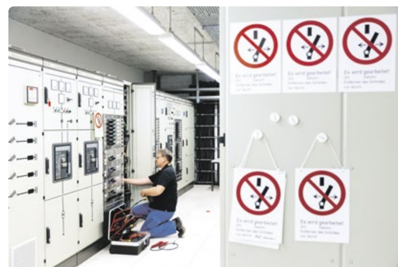
An einem Forschungsinstitut müssen sowohl die Anlagen und Geräte einwandfrei funktionieren als auch die Sicherheit der Mitarbeiter zu jeder Zeit voll gewährleistet sein.
