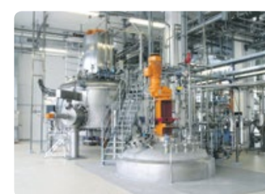
Mehrzweckanlage zur Herstellung von NCN-Produkten bei AlzChem.
