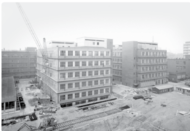
Die Baustelle für ZeTO I und ZeTO II in der Bauphase im Jahr 1968. Auch 50 Jahre nach seiner Fertigstellung im Jahre 1967 ist das ZeTO eine der weltweit flexibelsten Mehrzweck-Produktionseinrichtungen für Feinchemikalien.
