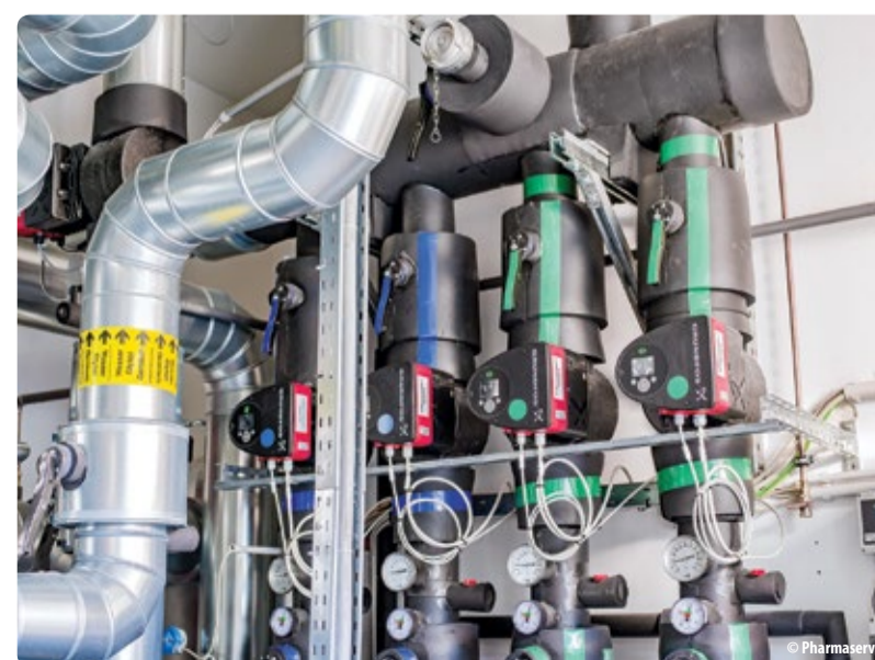
Datensicherheit, überzeugende Gebäudetechnik und Nachhaltigkeit durch Green IT – z. B. bei der Klimatisierung – vereinen sich im Pharmaserv Datacenter.
