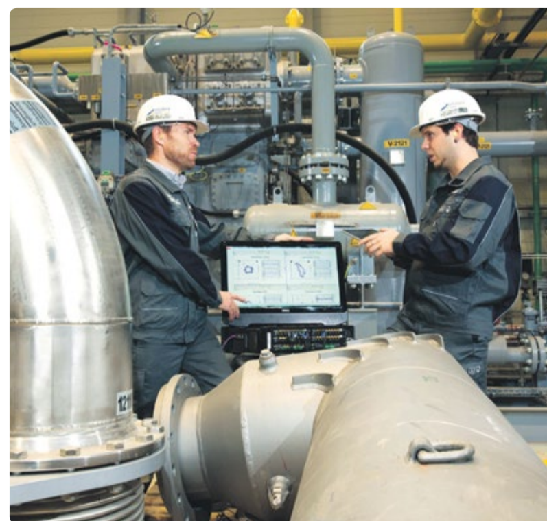
Dank Digital Engineering wird die Instandhaltung und Optimierung von Anlagen Realität.
