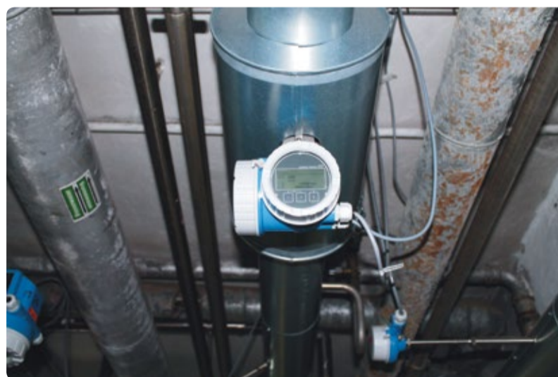
Prowirl F 200 im Dampfzulauf eines Wärmetauschers
