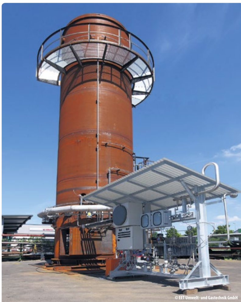
Über Bodenfackeln werden die bei An- und Abfahrvorgänge von Anlagen anfallenden Gase mit hohem Ausbrenngrad verbrannt, wie hier im schwedischen Stenungsund
