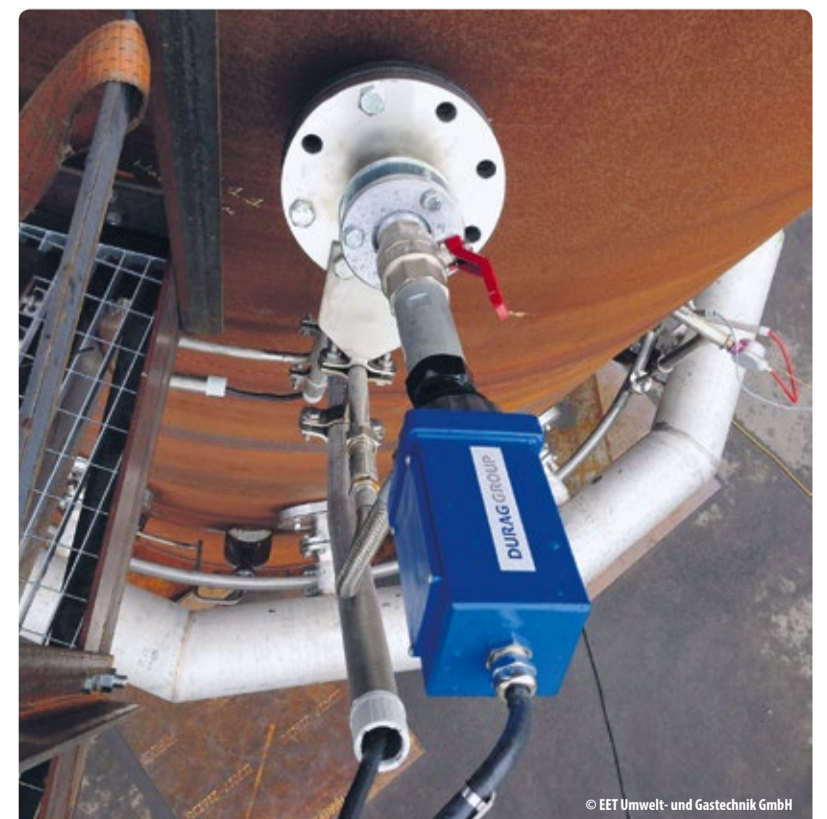
Ein Flammenwächter überwacht permanent die Farbe und Temperatur der Flamme, um die optimale Verbrennung der Prozessgase sicherzustellen
