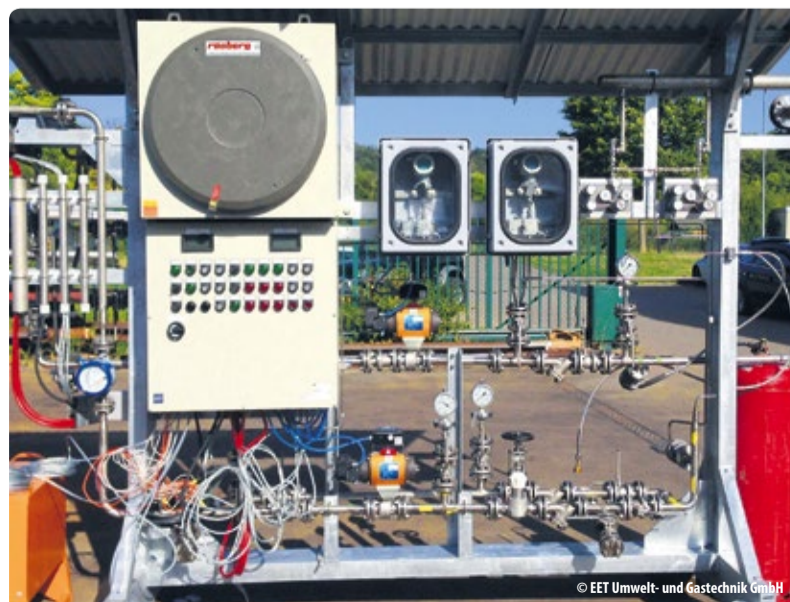
Im explosionsgeschützten Schrank (EEx d) ist die Mess- und Steuerungstechnik untergebracht.
