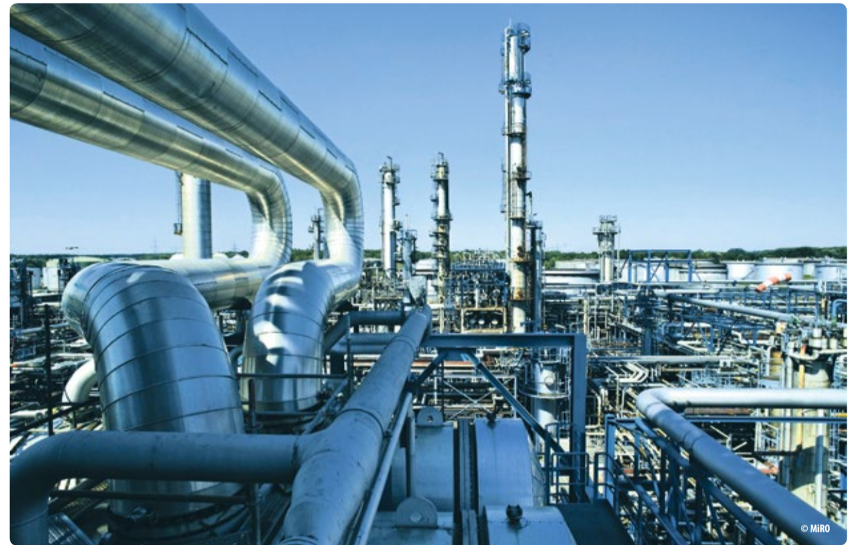
Die Mineralöelraffinerie Oberrhein (MiRO) in Karlsruhe. Beim Stillstand im Frühjahr 2015 stand nicht nur die TÜV-Prüfung auf der Agenda, sondern auch zahlreiche Einzelprojekte zur Erhöhung der Anlagenflexibilität, zur Verbesserung der Energieeffizienz sowie der Prozesssicherheit.
