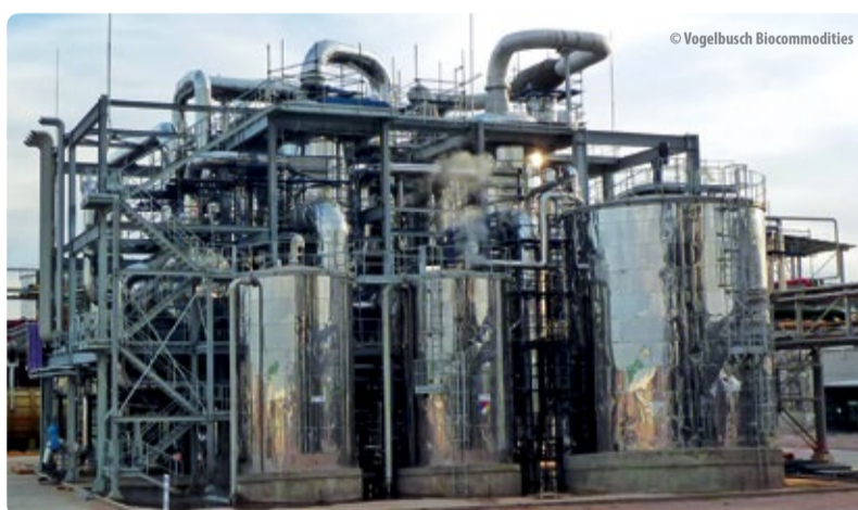
Bei der Planung der Verrohrung - hier eine Eindampfanlage - ist die geeignete Software-Unterstützung von großem Nutzen.
