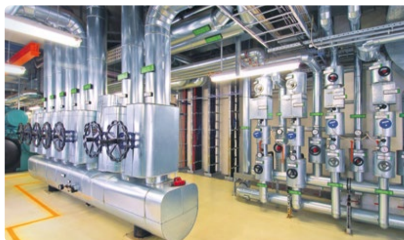
Mit wirtschaftlichen Dämm Lösungen lassen sich in der Industrie jährlich bis zu 480 PJ Energie und 37 Mt CO 2 einsparen.
