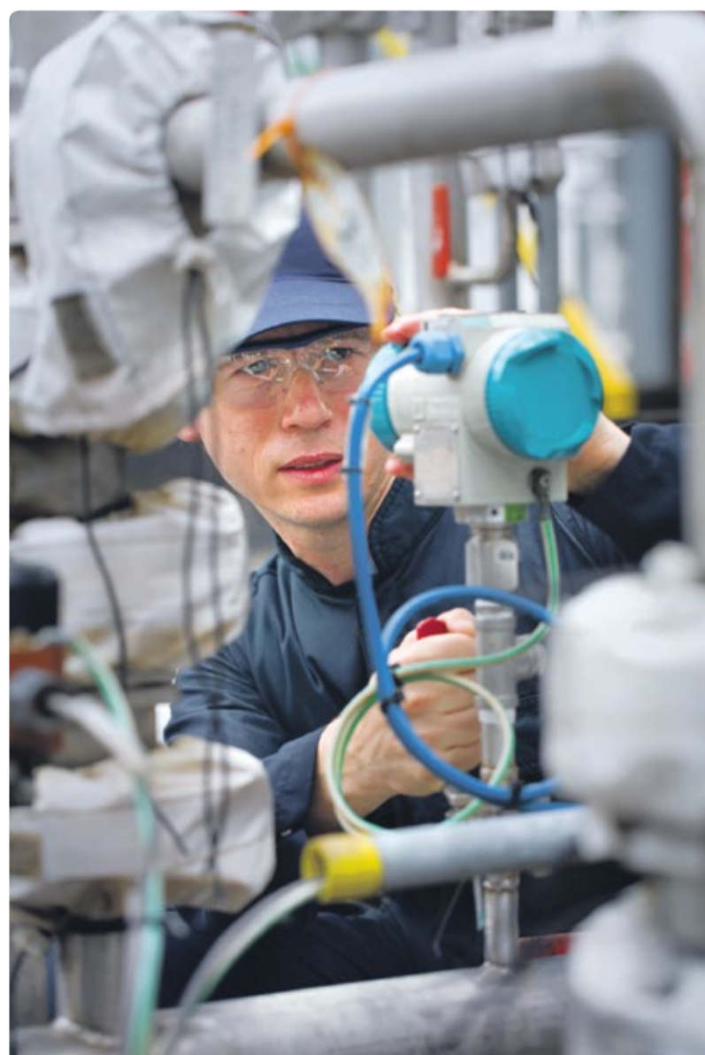
Auch bei der Feldgeräte-Instrumentierung am Reaktor 5 in Mechelen ist Siemens beteiligt: Hier kommen diverse Sitrans Messumformer zum Einsatz.
