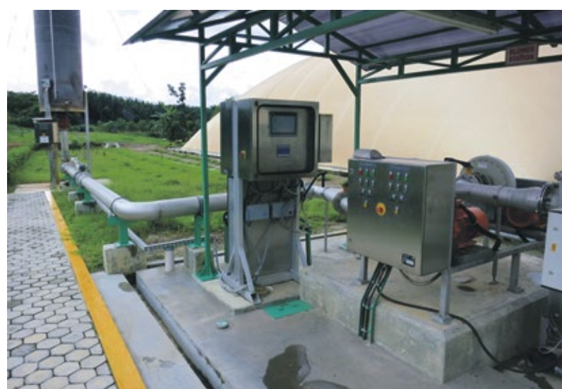
Das Gasanalyse-System INCA misst die Zusammensetzung von Erdgas – wie hier in einer Biogasanlage in Indonesien (Foto: Torsten Haug)
