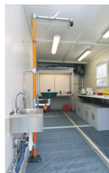
Abb. 2: Innenbereich mit umfangreicher Sicherheitsausrüstung: Lufttechnik-Arbeitsplatz, F90-Unterbaustränke, Not- und Augendusche
