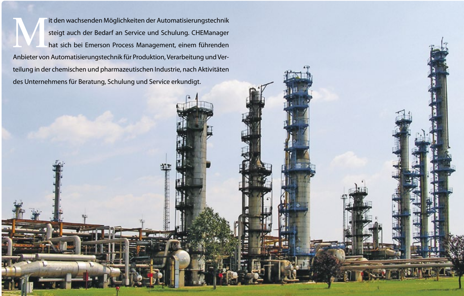
Der SmartProcess Distillation Optimizer von Emerson findet bei fünf der sechs Destillationskolonnen im Gaswerk Algyö von MOL in Ungarn Anwendung.
