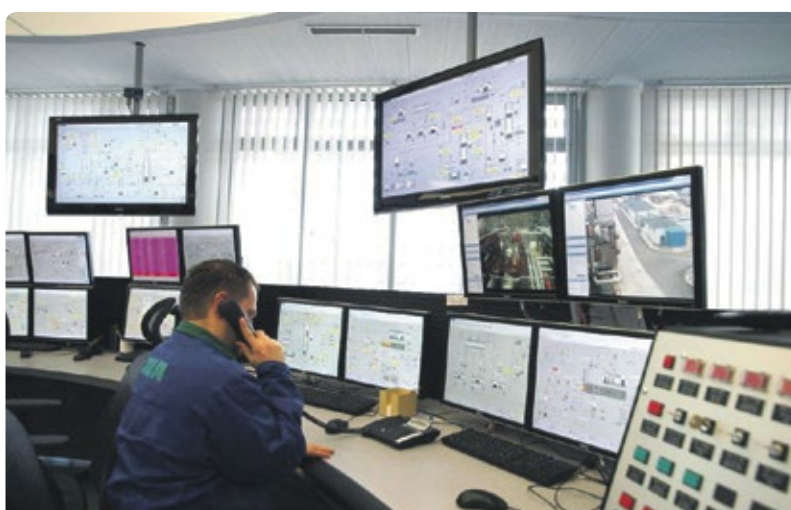
Emerson installierte eine integrierte Lösung für die neue Hydrocrackanlage in der INA Rijeka Raffinerie in Kroatien. Blick in die neue zentrale Leitwarte der Raffinerie.
