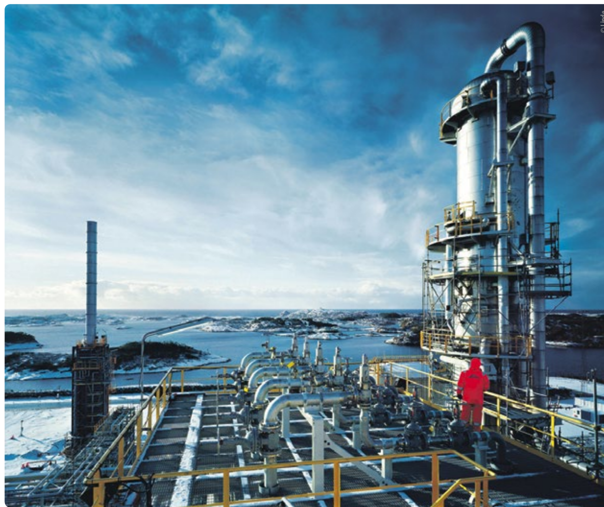
Linde-Anlagentechnologie zur Gewinnung des umweltfreundlichen Kraftstoffs LPG (Liquified Petroleum Gas)
