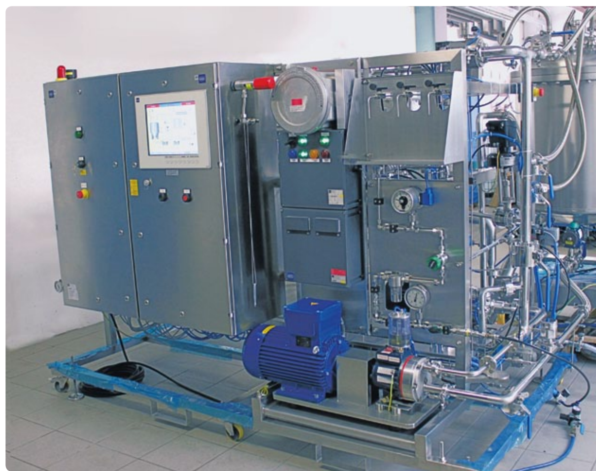
Mobile Nanofiltrationsanlage mit überdruckgekapseltem Schaltschrank in Zündschutzart Ex p.
