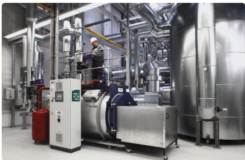
Elektrische Energie und Wärme: Effiziente Kraft-Wärme-Kopplung im werkeigenen Blockheizkraftwerk sorgt für bedarfsgerechte Stromversorgung und im Notfall für Unabhängigkeit von regionalen Stromversorgern.
