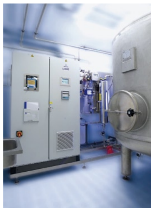
Abb. 2: Die Kompaktanlage Loopo der Firma Christ verteilt das Aqua Purificata und sanitisiert und überwacht es konstant. Das Rack-System stellt eine platzsparende Lösung dar.
