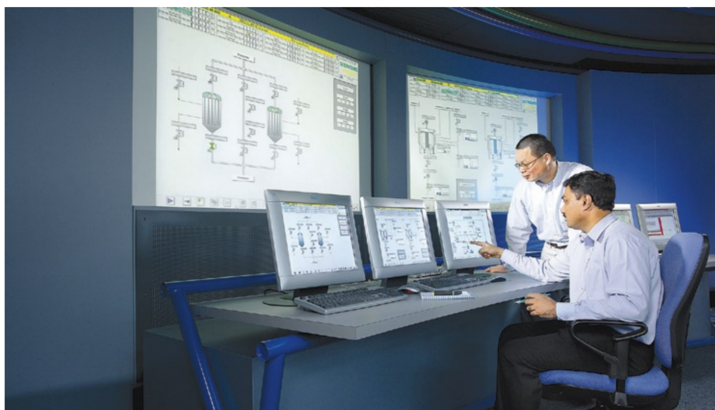
Abb. 1: Das Prozessleitsystem PCS7 von Siemens ist flexibel und durchgängig bis zum Feldgerät. Es ermöglicht die Kontrolle und Diagnose über alle Assets einer Automatisierung.
