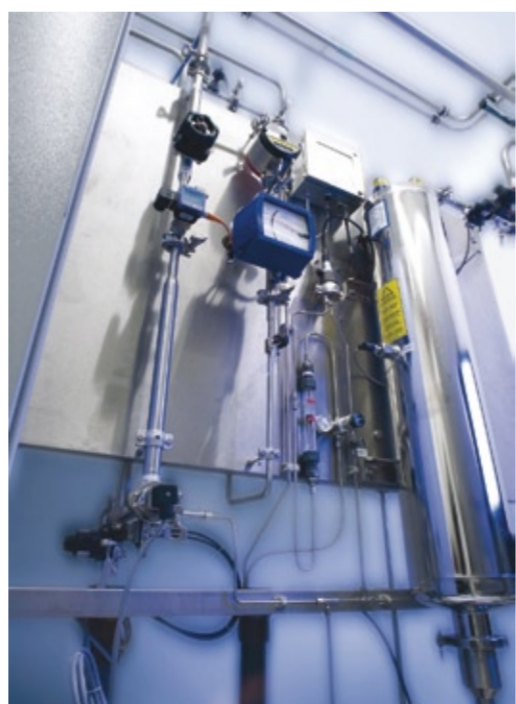
Abb. 3: Ozon- und UV-Nachbehandlung sorgen dafür, Aqua Purificata kontinuierlich keimfrei zu halten und bieten zusätzlich Schutz für das Ringleitungs- und Tanksystem.
